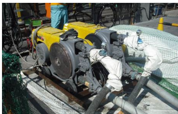
2台交互運転にて稼働中
