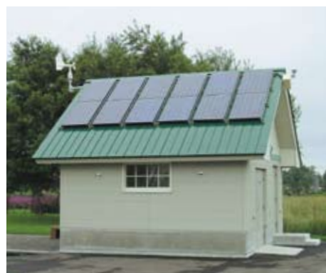
▲ 太陽電池発電システム
